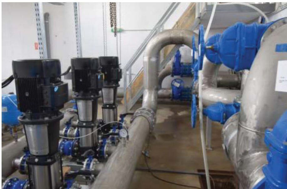
Imagina 3. Stația de pompare echipată cu pompe cu turația variabilă
