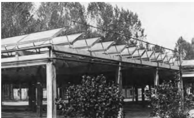
Instalație solară de preparare a apei calde, de pe litoral, montată deasupra parajelor
