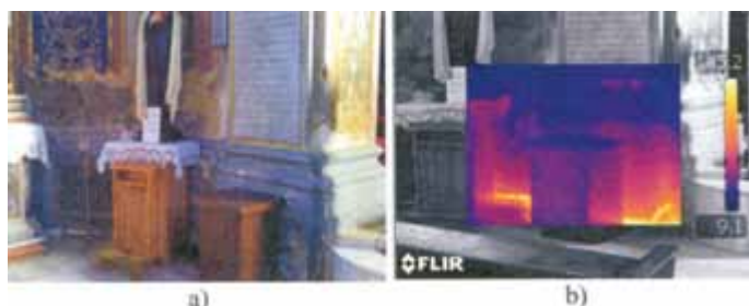
Figura 1 a) Degradări în urma apariției condensului la soclu b) Degradări care, surprinse în imagini cu termoviziune, redau zonele cu punți termice ce favorizează apariția condensului
