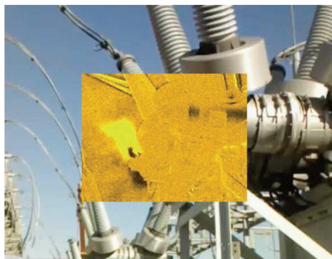
Fig. 2: O imagine termică cu detecția gazului suprapusă pe o imagine în spectrul vizibil a unui întreruptor
