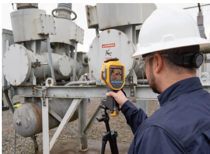
Fig. 1: Un tehnician utilizează camera de detecție gaz Fluke Ti450 SF6 pentru a inspecta îmbinările cu șuruburi
