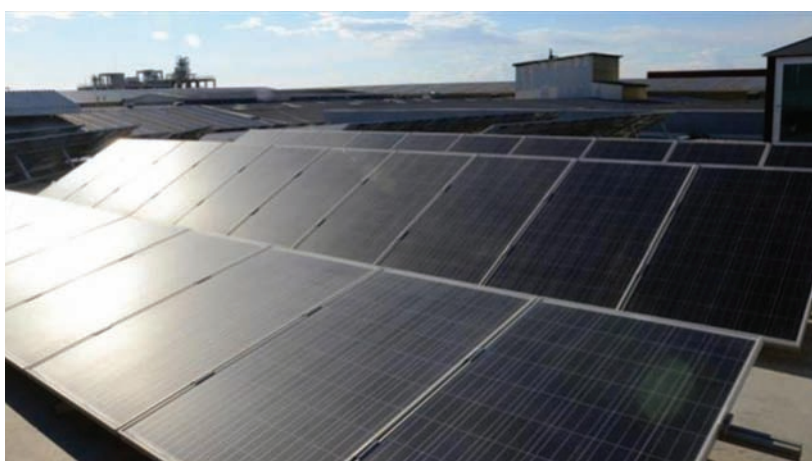
Cel mai puternic acoperiș solar din lume, construit de Panasonic pentru o firmă turcă: 18325 panouri solare, 36000 metri pătrați suprafață, 5,8 MW putere instalată, 7,5 GWh producție anuală de energie. Sursa Foto : Anadolu Agency
