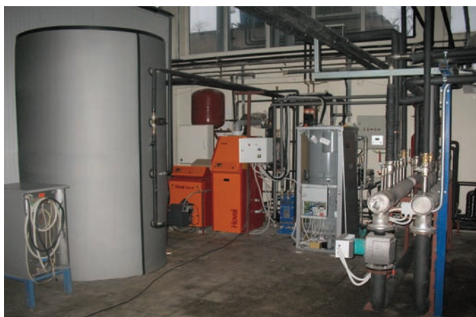
Foto 1. Sistem experimental cu energie solară pentru climatizarea de confort
