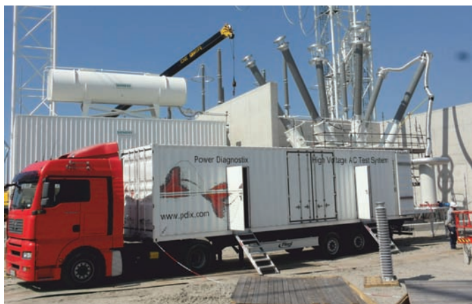
Testarea unui transformator cu autolaboratorul de IT CA
