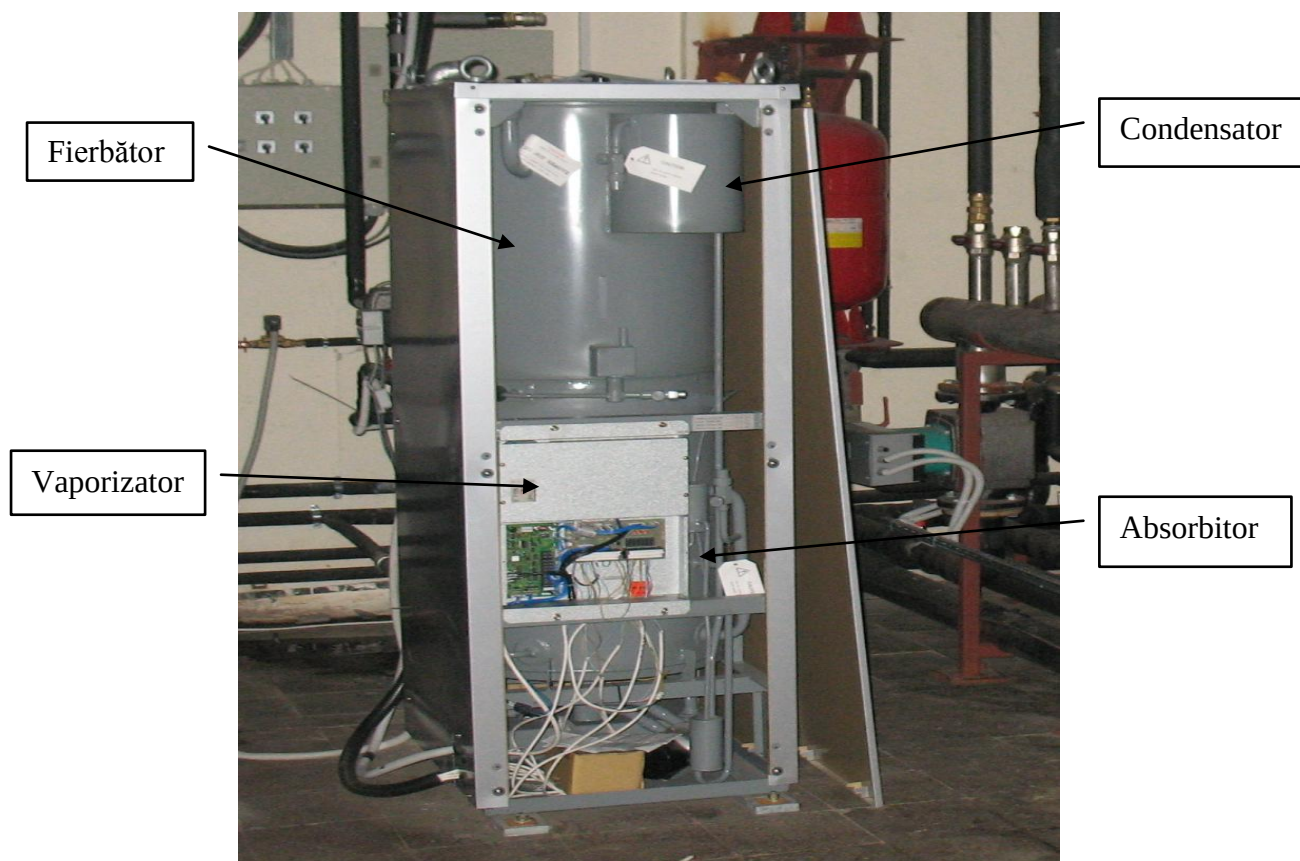
Figura 5.9: Sistemul frigorific cu soluție LiBr-H 2 O din laboratorul de Termotehnică din U.T.C.B.
