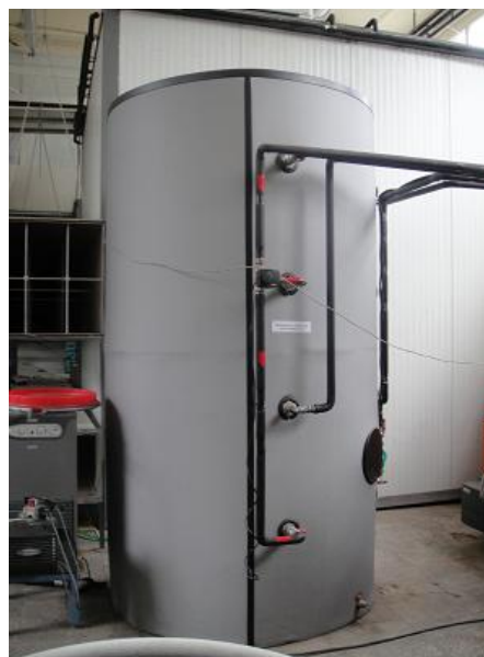
Figura 5.8: Rezervor de stocare al apei calde
